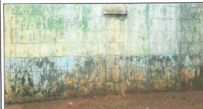
Foto 3: Se observa el estado de la pintura del establecimiento la parte de atrás.
