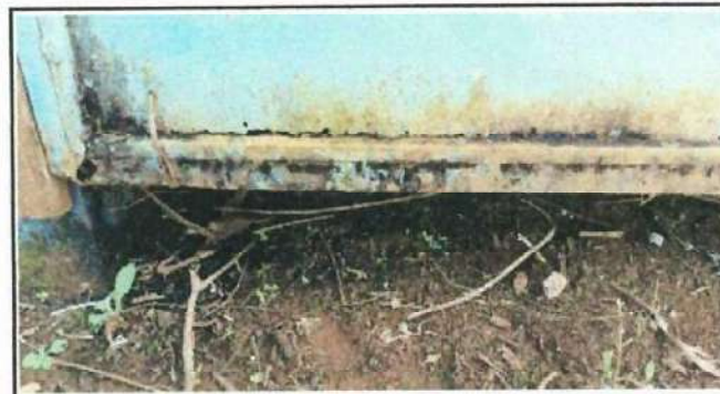
Foto 4: Se observa deterioro de las puertas a cambiar.
